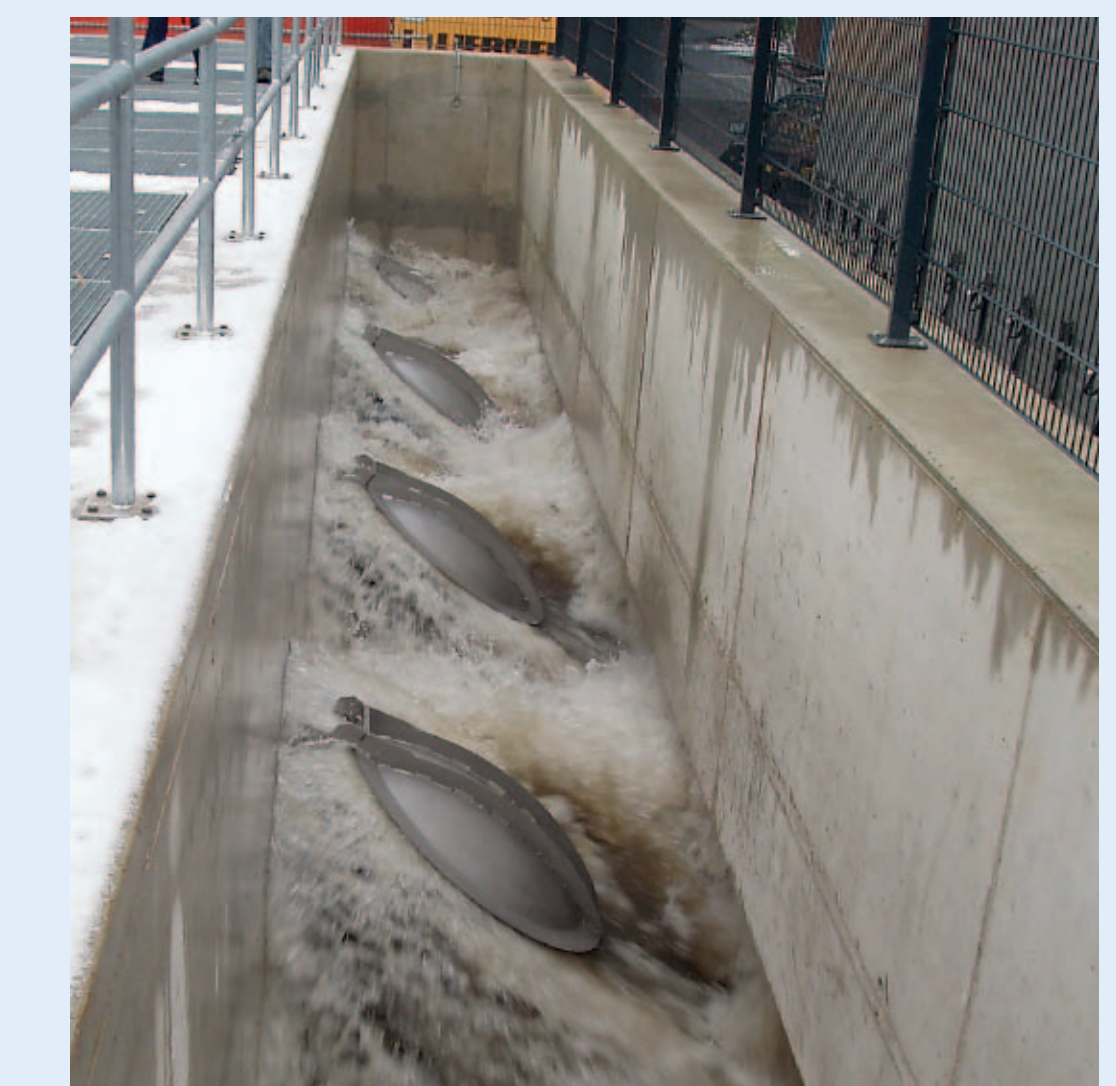
Pumpen des Schöpfwerks Speyerbach in Betrieb
