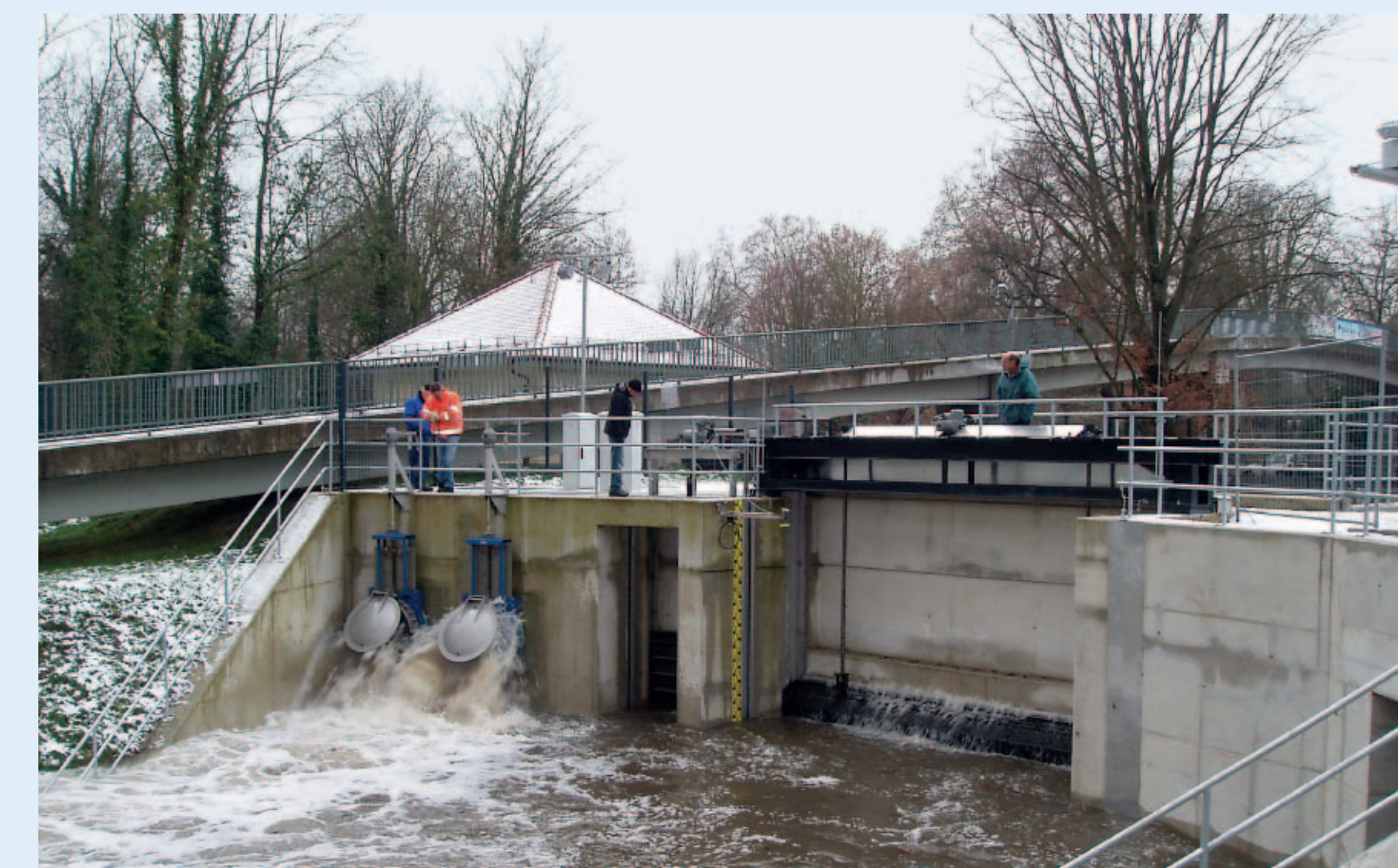
Entlastung des Hilgardgrabens, der Absperrschieber ist geschlossen
