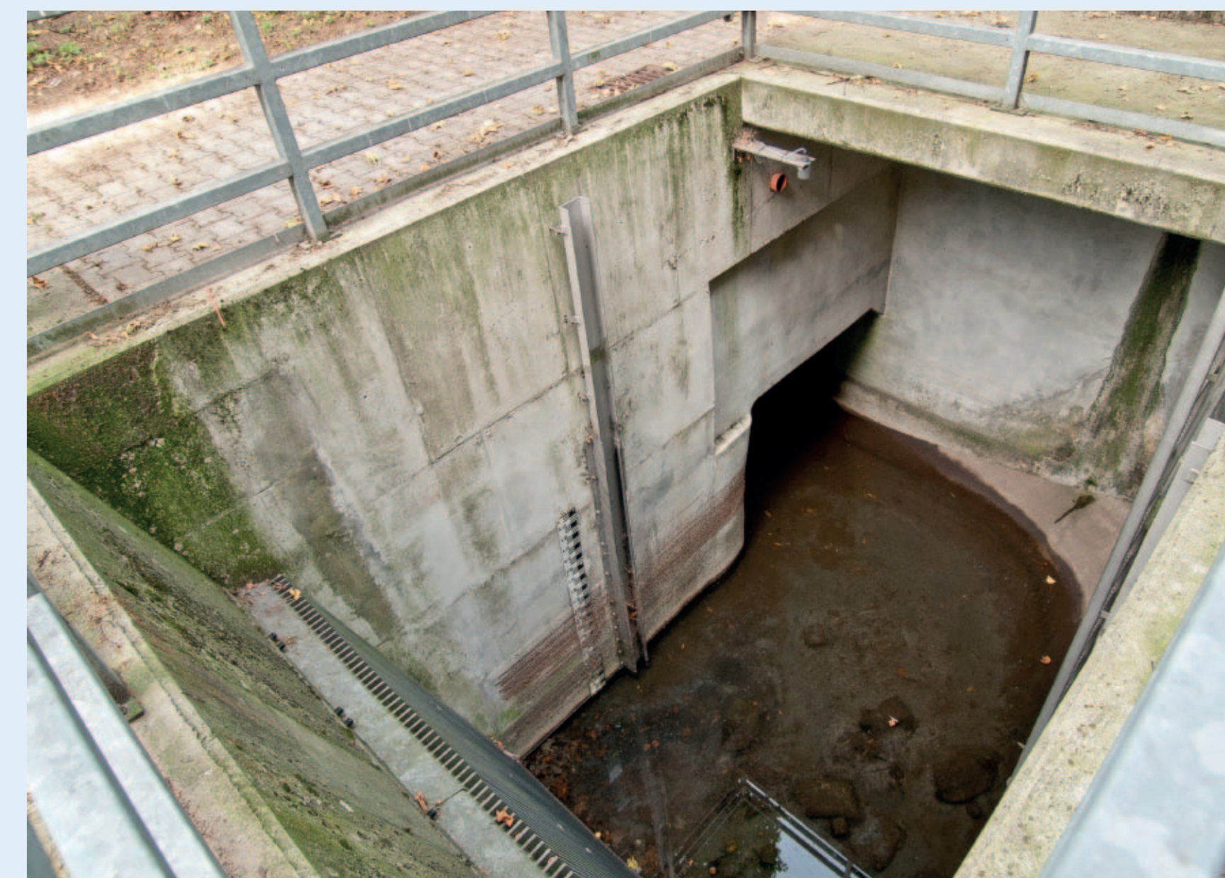
Zulauf Fischergraben zur Pumpe mit Rechen
