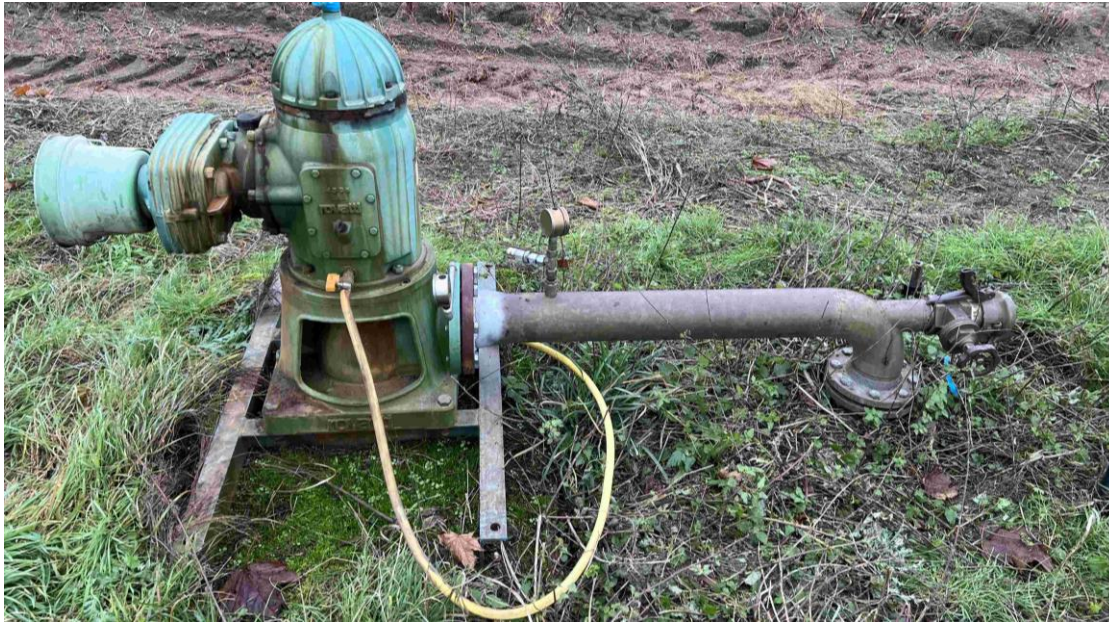
Abb. 1 Bohrlochwellenpumpe mit Anschluss (DN 100) an das Leitungsnetz sowie Entnahmestelle (Perrot-Kupplung, 70 mm)
