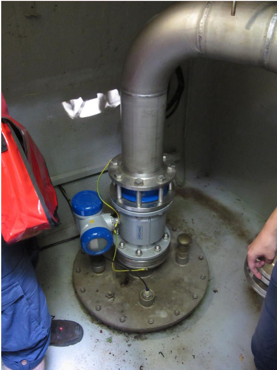
Abb. 7 Digitaler Wasserzähler - Festinstallation in Brunnenschacht bei Groß-Gerau (Quelle: BGS UMWELT 2023)
