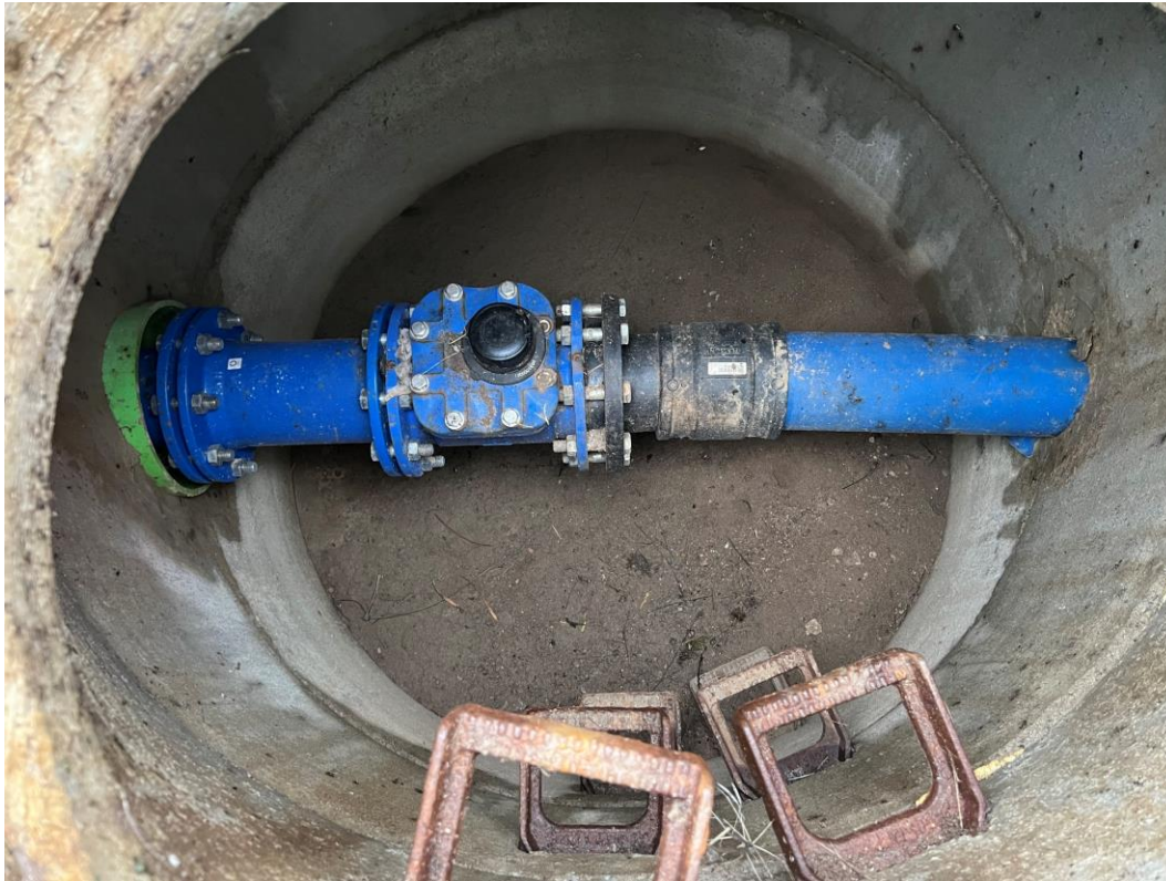
Abb. 6 Mechanischer Wasserzähler - Festinstallation in Schachtbauwerk bei Mecktersheim mit gerader Ein- und Auslaufstrecke; Quelle: envi-systems (2023)
