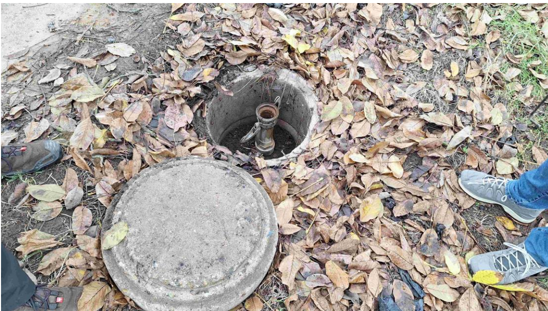
Abb. 3 Entnahmestelle des Leitungsnetzes (Perrot-Kupplung, 70 mm) mit Betonschutzrohr
