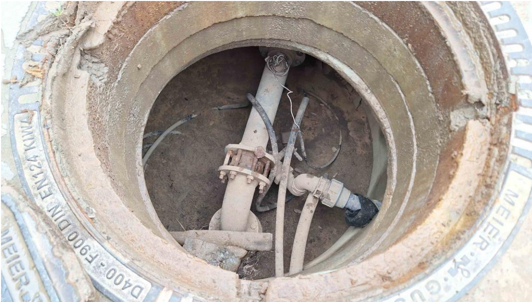
Abb. 2 Brunnenschacht; Einspeisung ins Leitungsnetz mit Rohranschluss DN 100
